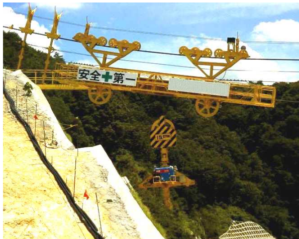
ケーブルクレーン
